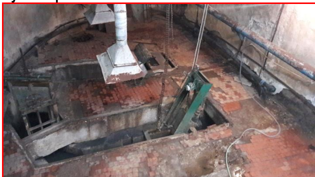
Фото 3: Главная насосная станция сточных вод мун. Комрат
