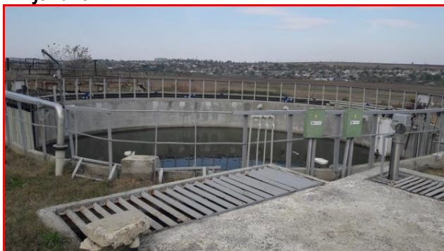
Фото 12: Очистные сооружения сточных вод в г. Вулканешты
