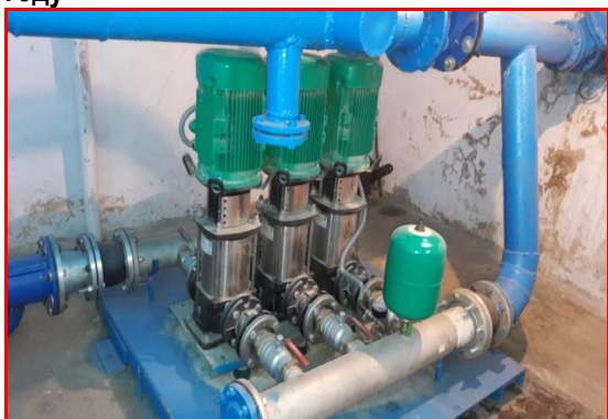
Фото 2: Насосная станция, обновлённая в 2017 году
