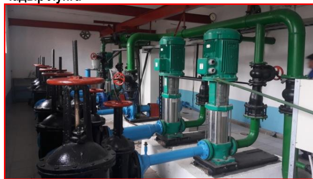
Фото 5: Главная насосная станция в мун. Чадыр Лунга
